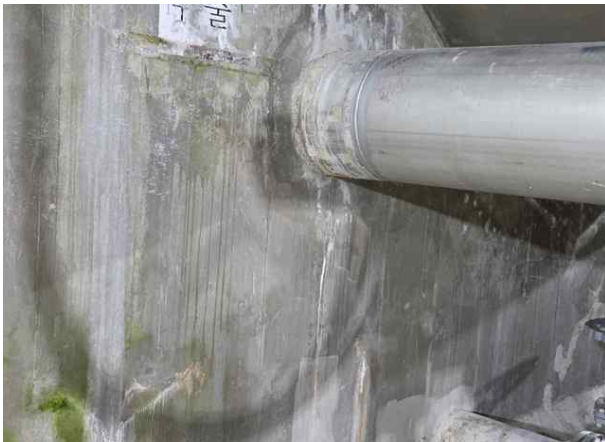
손상내용 유출밸브실 벽체 균열부백태 손상원인 손상부 수분침투
