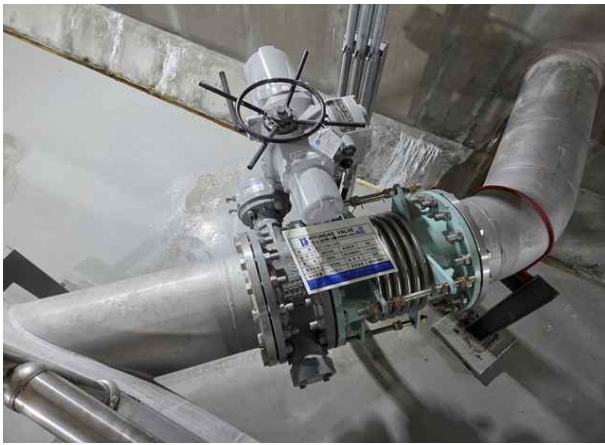
손상내용 유입 밸브, 배관, 볼트류 상태양호 손상원인 -
