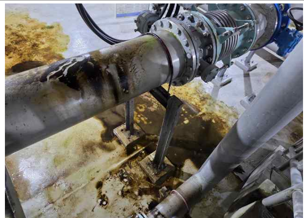
손상내용 유출밸브실 오일누유 손상원인 결합불량
