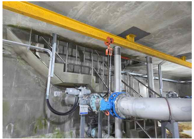
손상내용 유출 밸브, 배관, 볼트류 상태양호 손상원인 -
