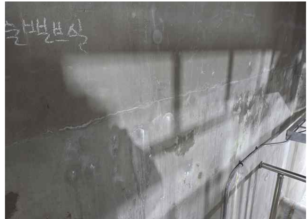
손상내용 유출밸브실 벽체 균열(0.3mm미만) 손상원인 건조수축
