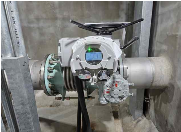
손상내용 유입 액츄에이터 상태양호 손상원인 -
