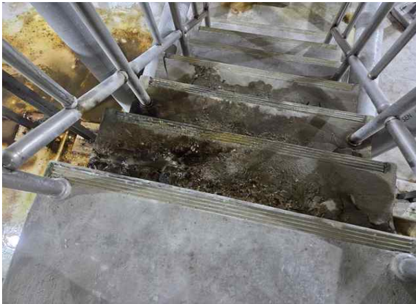
손상내용 유출밸브실 계단 표면박리 손상원인 동결융해
