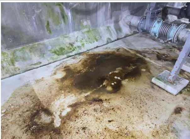
손상내용 유출밸브실 바닥슬래브 체수 손상원인 외부우수 유입
